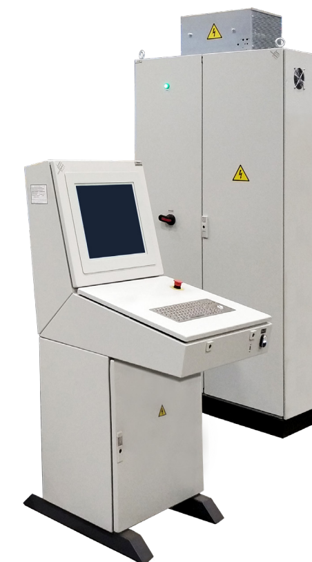
Пульт управления и силовой шкаф Горизонтальной Ударной установки ГУС ВСТС-450/300
